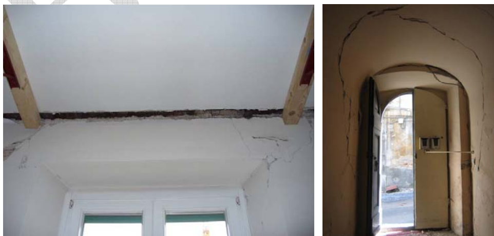
Figura 6: Distacco del solaio (sinistra) e della volta (destra) dalla facciata, per incipiente ribaltamento
